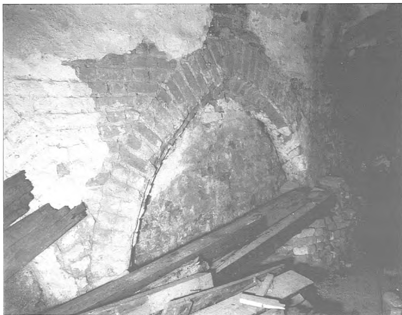
Obr. 6: Čp. 151/I. Hrotité cihelné arkády na hranici s čp. 153/I z „opukové“ fáze domu, poškozené požárem.
