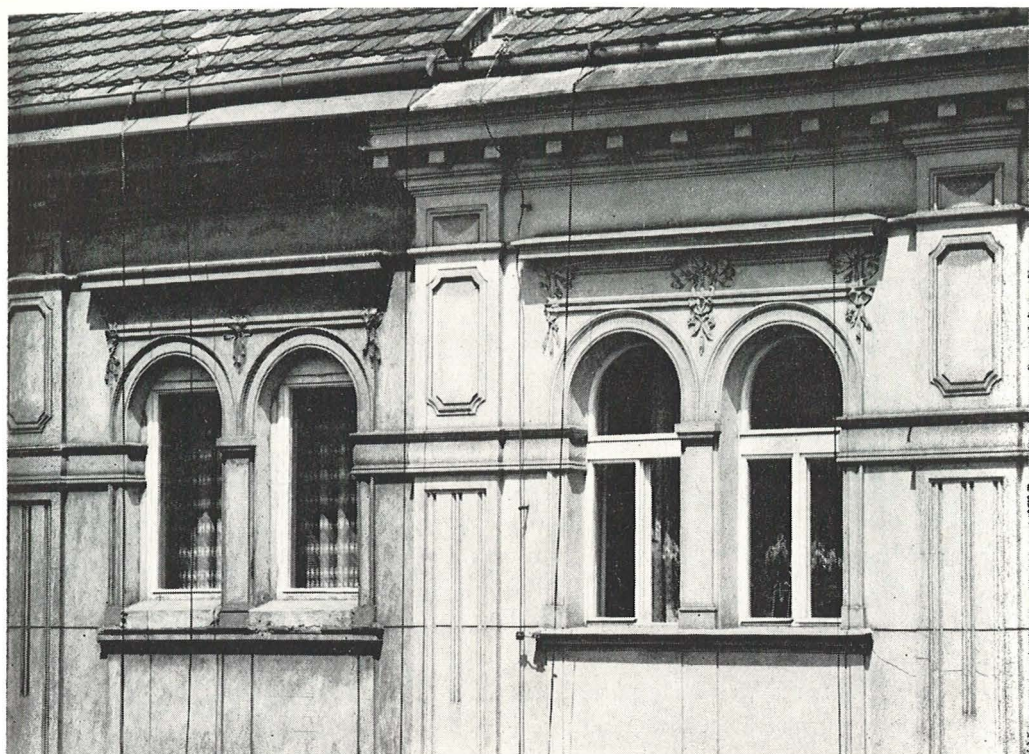
Grafická ulice v Praze 5 – nevhodná úprava oken
