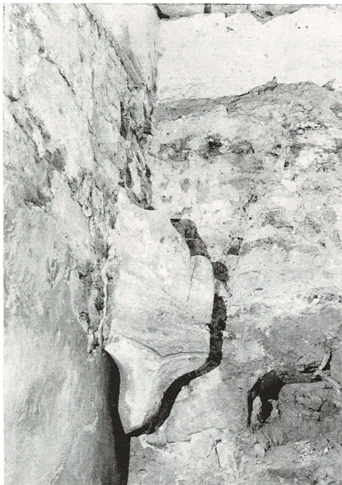
Klenební konzola s náběžnými štitky z přízemí věže čp. 403/I, stav po odkrytí. Zachováno spolu s původními omítkami stěn
