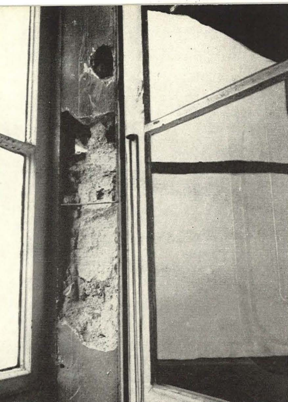
Arcibiskupský palác — jižní průčelí — sonda s nálezem olejové barvy a drátěné spojnice rámů. Je patrné odhalené cihelné ostění
