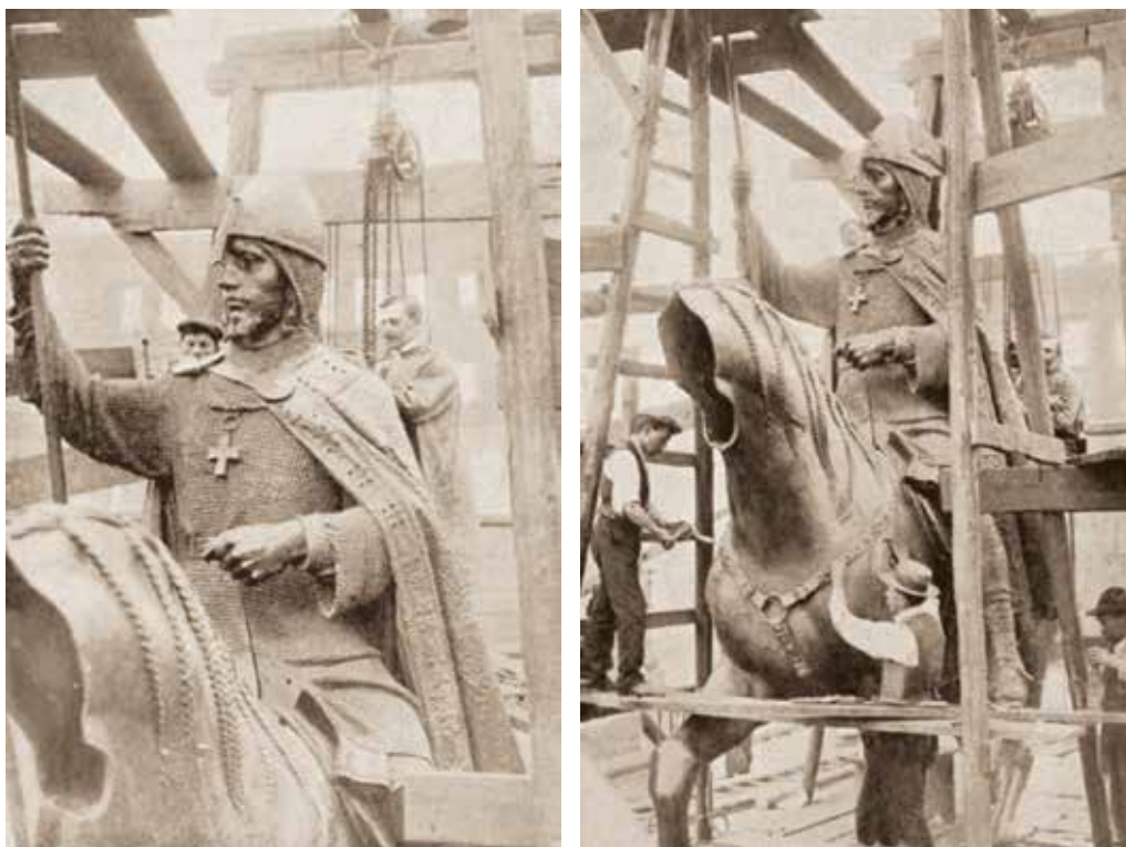
Obr. 5. Osazování bronzového odlitku jezdecké sochy sv. Václava na podstavec (převzato ze sine 1912b, foto Vojta).
