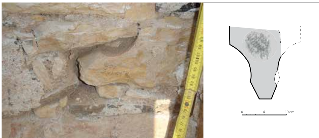
Obr. 4. Zlatníky u Prahy, kostel sv. Petra a Pavla. Gotický fragment opukového klínového vyžlabeného žebra s opracováním ložné plochy, zazděný v západní průčelní zdi lodi. Profilace byla bezpečně doplněna na základě ploch článku zachovaných v hloubce ložné spáry zdiva, v líci hůře zřetelných. Zaměření přístupných částí bylo provedeno hřebem s výsuvnými jehlicemi (foto a zaměření M. Kovář, 2018; překreslil M. Semerád, 2019).
