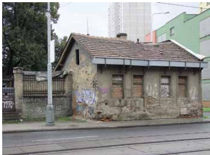
Obr. 4. Praha 4-Michle, čp. 218, rodný dům Jana Kubelíka. Pohled od severu z ulice U Plynárny. Tristní stav budovy se bohužel od roku 2010 vůbec nezměnil, přibyla nová graffiti a ubylo omítky (foto J. Baláček, 2010).
