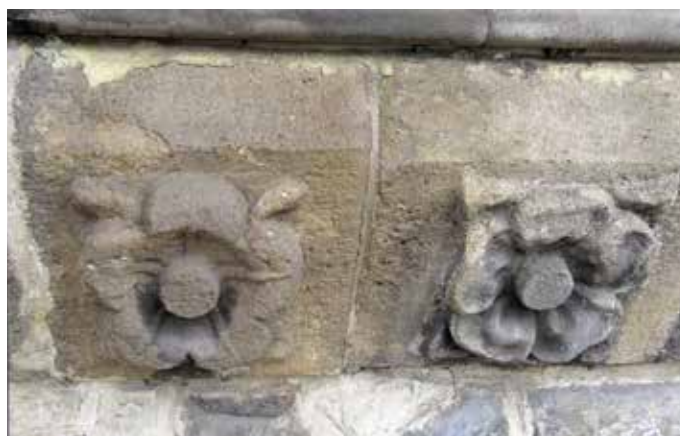
Obr. 2. Praha 1-Staré Město, čp. 1/1, Staroměstská radnice, věž. Motiv pětilistých růží na korunní římsě, stav před obnovou (foto L. Bartoš, 2017).
