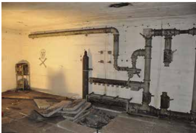
Obr. 7. Kryt na ppč. 144, Praha 6-Bubeneč. Hlavní prostor krytu se vzduchotechnikou. Vpravo filtrační zařízení, vlevo v rohu zásobník na filtry (foto M. Bureš, 2014).
