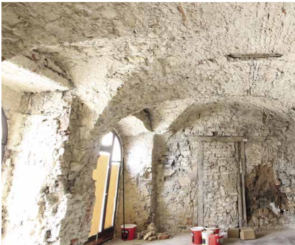
Obr. 7. Praha 1-Staré Město, čp. 420/I, Uhelný trh 1. Místnost v jižní části přízemí, pohled k jihu (foto L. Bartoš, 2015).
