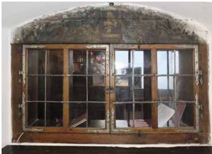
Obr. 15. Praha 1-Hradčany, kostel Panny Marie Andělské. Pohled na okno ze sakristie (foto L. Bartoš, 2015).
