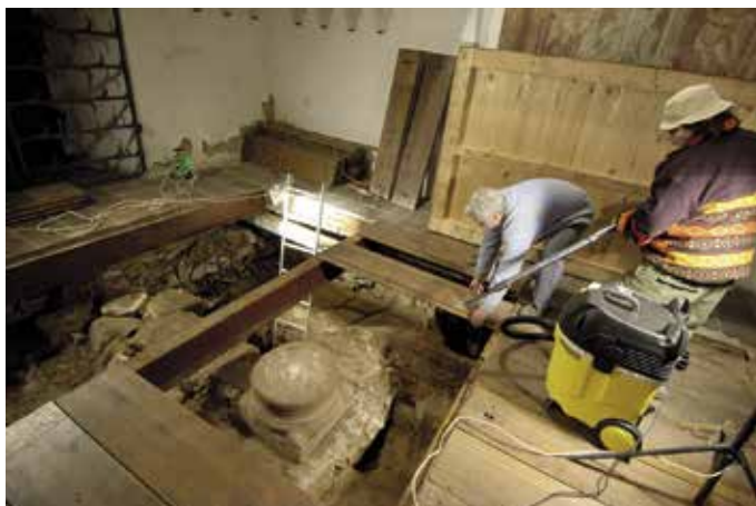
Obr. 2. Praha 8-Dolní Chabry. Kostel sv. Jana Křtitele. Odstraňování podlahových desek v patřích nad patkou románského sloupu. Snímek dobře ukazuje zvolený způsob zastropení (foto M. Tryml, 2010).
