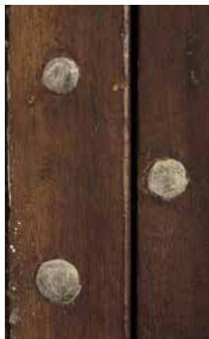
Obr. 11. Praha 1-Hradčany, čp. 169, Úvoz 6. Celkový pohled na prvek č. 2 ze schodiště (foto P. Havlík, 2014).
