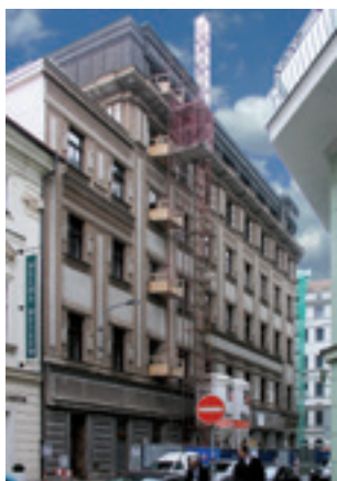
Obr. 3. Praha 1-Nové Město, nárožní dům čp. 1308/II na křižovatce Panské a Jindřišské ulice v době rekonstrukce na hotel v roce 2011 (foto P. Starec).
