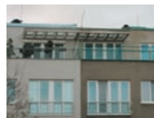
Obr. 8. Praha 6–Střešovice, čp. 676–680. Za Hládkovem 20, 18, 16, 14 a 12. Blok bytových domů, detail slunolamů (foto A. Křížová, 2011).
